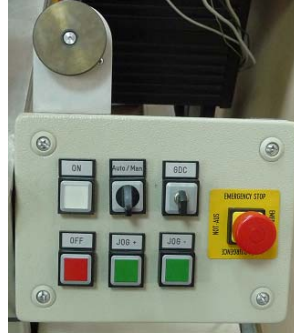
Şekil 5. Manüel Kontrol Paneli
